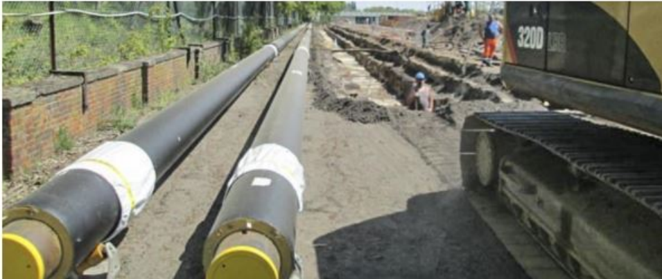
De buizen die het hete water moeten transporteren. © eandis
